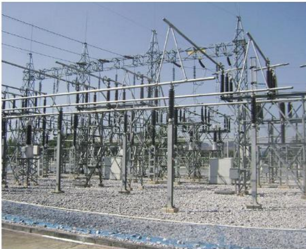
สถานไฟฟ้า
