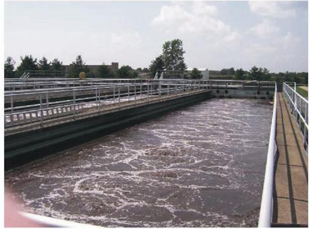
บ่อบำบัดน้ำเสีย
