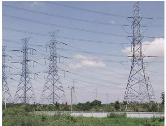
เสาไฟฟ้า
